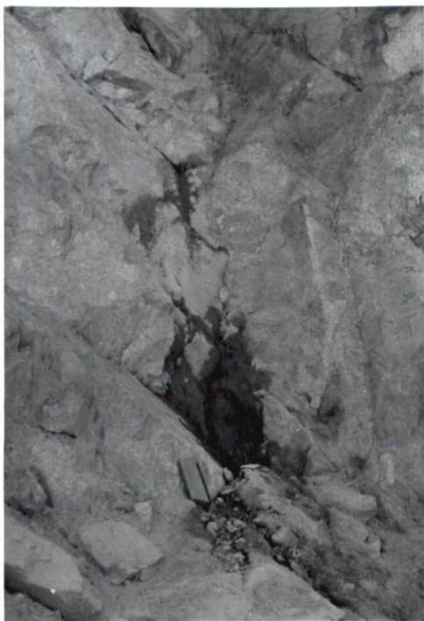
FOTOGRAFIA NO 26 SURGENCIAS DE AGUA
