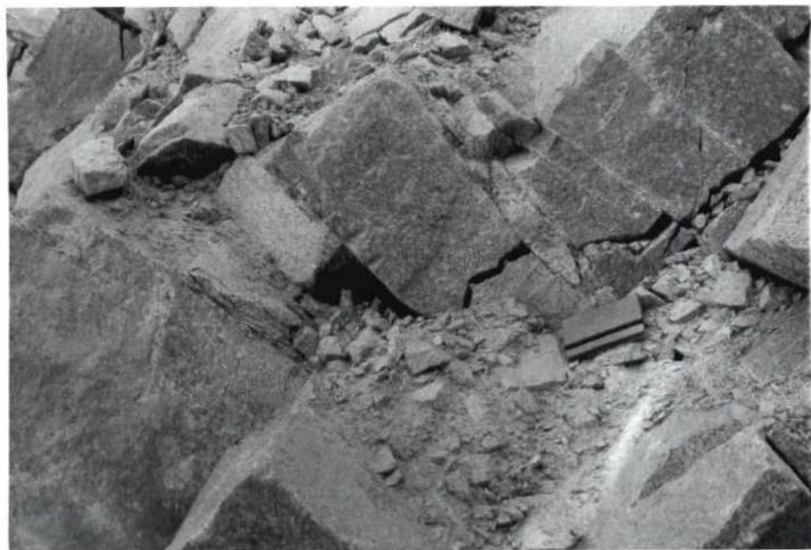
FOTOGRAFIA N o 19 DETALLE DE RELLENO LAJOSO
