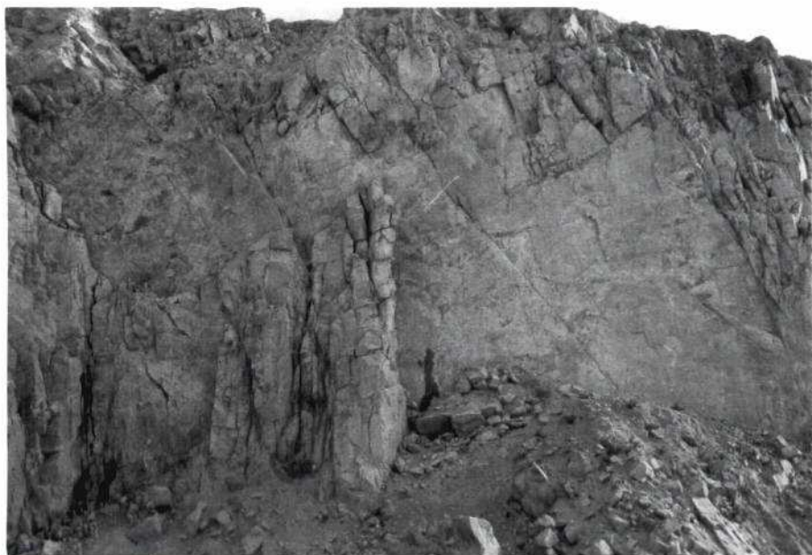
FOTOGRAFIA Nº 10 DETALLE DE FRACTURACION Y TRAZAS DE AGUA EN EL FRENTE OESTE
