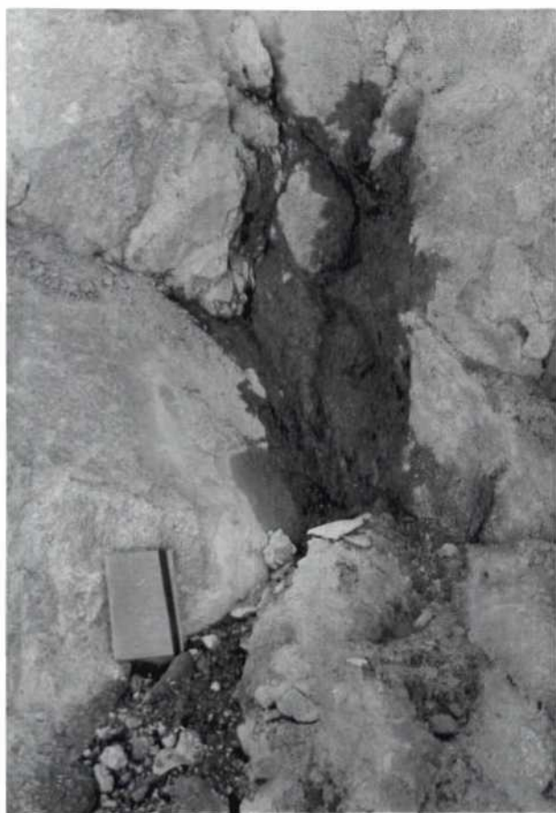
FOTOGRAFIA NO 27 DETALLE DE SURGENCIAS DE AGUA
